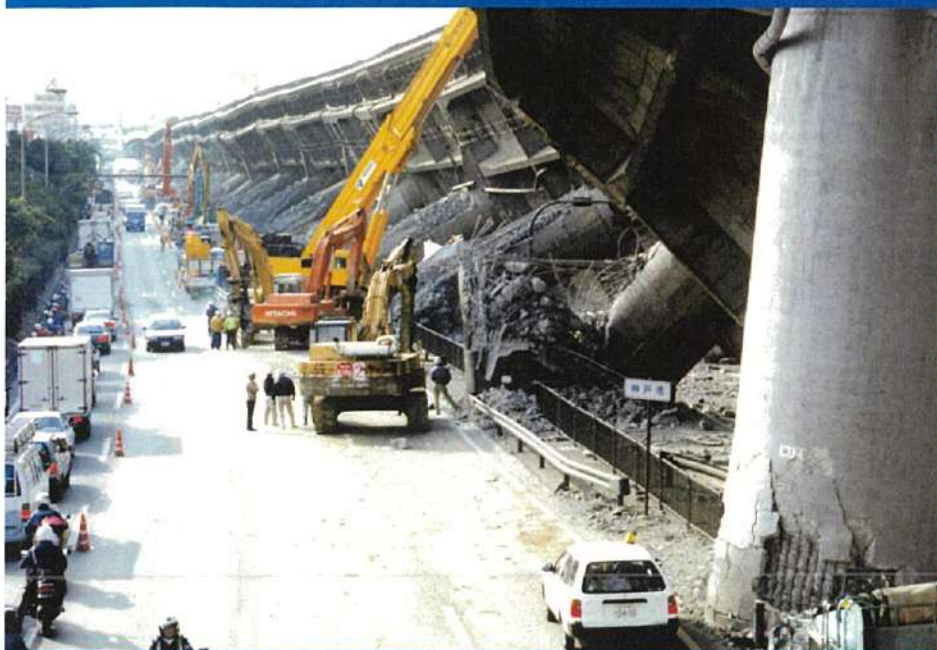
横倒しになった高速道路は震災の被害の甚大さを伝える象徴的なシーンとなった。震災発生から2日後、復旧工事が始まっている 神戸市東灘区 1995.1.19 This collapsed elevated highway became an iconic scene showing the enormity of damage caused by the earthquake. Reconstruction began 2 days after the quake, Higashi Taifa Ward, Kobe City. 19 January 1995.
